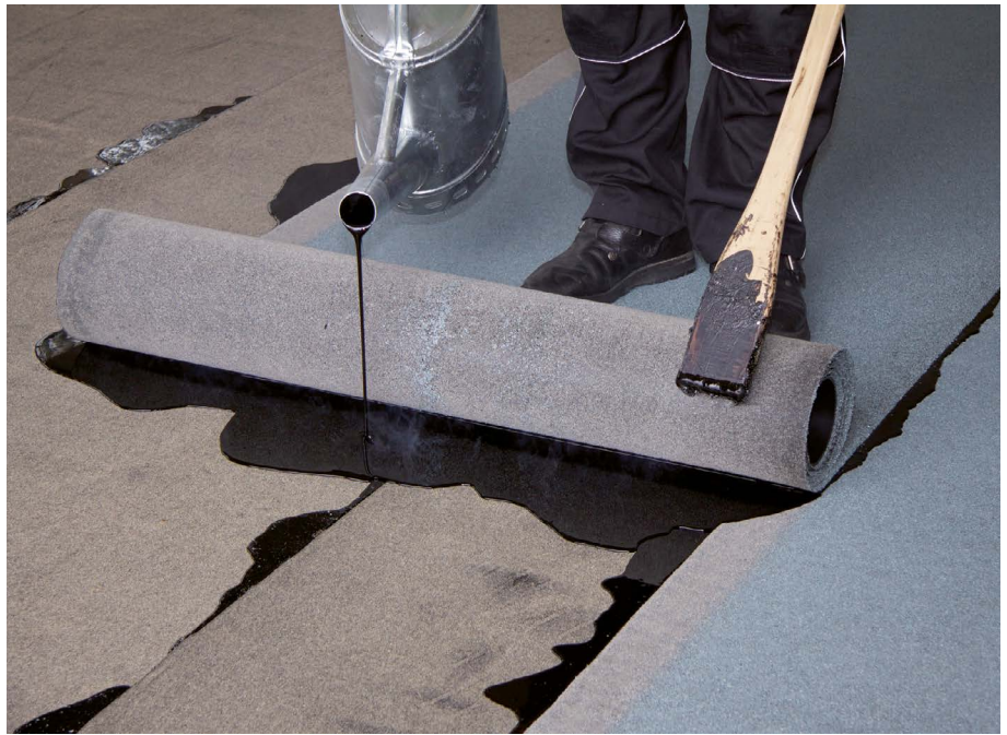
Generell gilt: Als Arbeitgeber und Inhaber eines Dachdeckerunternehmens haben Sie nach § 7 der Gefahrstoffverordnung die Aufgabe, Ihre Beschäftigten zu schützen.
